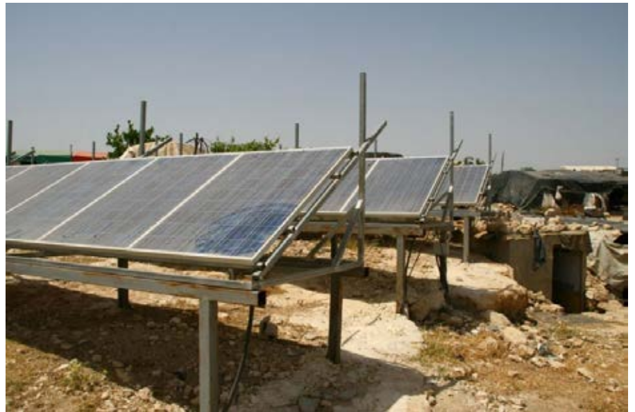
الالواح الشمسية التي وضعتها منظمة "كومط"، والتي توفر الكهرباء لأهالي خربة سوسيا، التي ترفض إسرائيل أن تربطها بشبكات الكهرباء والمياه
